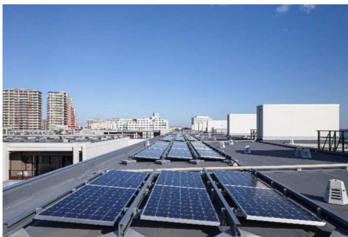
ザ・パークハウス 新浦安マリンヴィラ 屋上太陽光パネル
